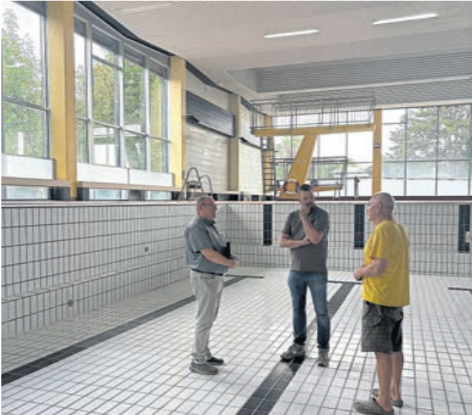
Leeres Becken mit großen Problemen. Deswegen wird das Hallenbad für rund drei Monate saniert. Foto: Stadt Weiterstadt
