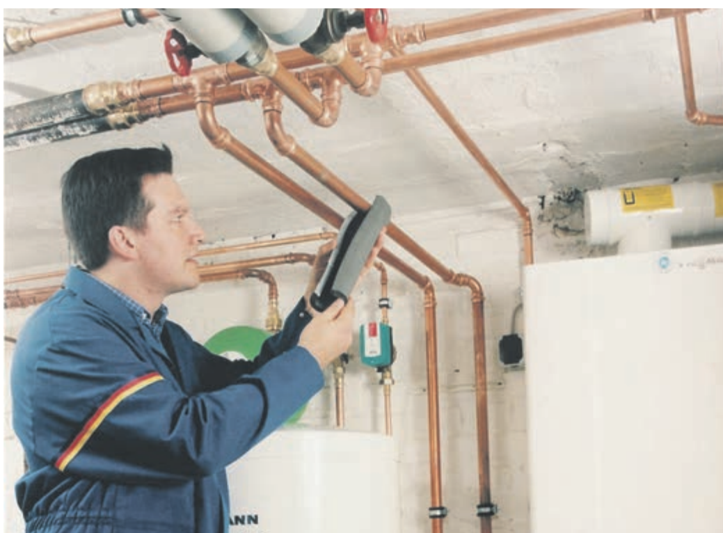
Kupfer bewährt sich seit vielen Jahrzehnten in der Hausinstallation und ist auch bei Modernisierungen eine wertbeständige Investition. Foto: djd/Kupferverband
