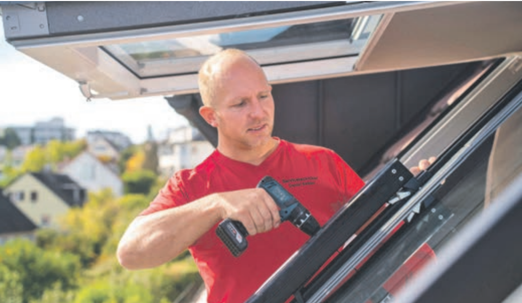
Besonders bei Dachfenstern, die konstruktiv noch in gutem Zustand sind, lassen sich viele typische Verschleißerscheinungen wirtschaftlich sinnvoll beheben. Foto: djd/TLS-Dachfenster
