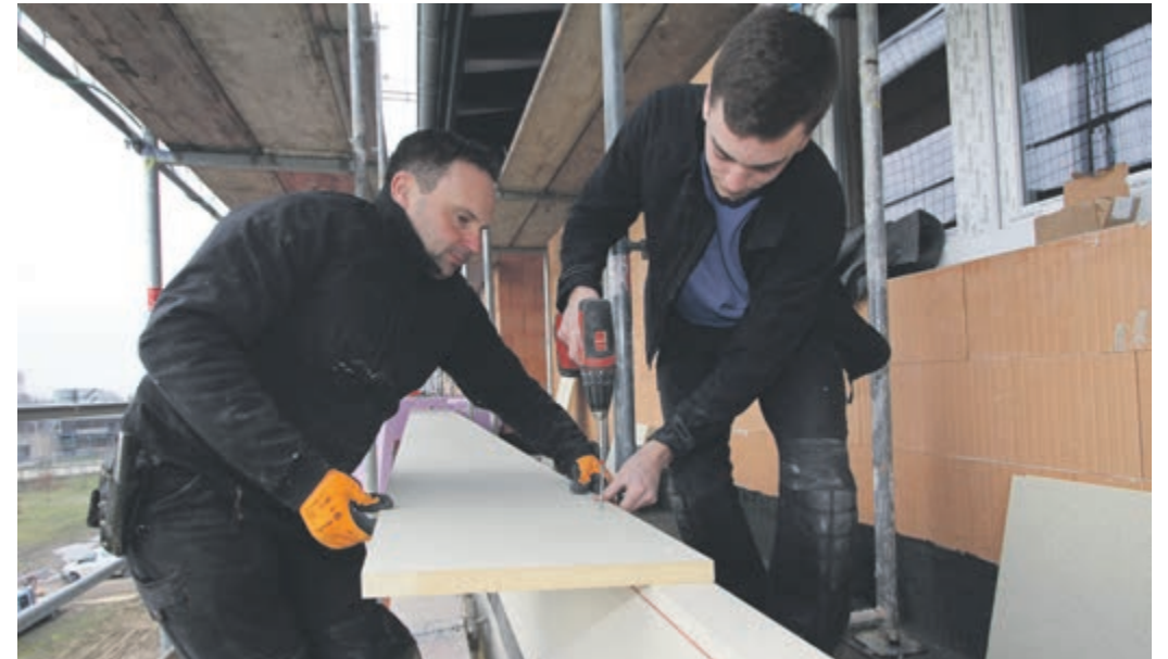
Aus Polyurethan-Dämmresten lässt sich ein Funktionswerkstoff upcyclen, der vielseitig auch am Bau eingesetzt werden kann. Fotos (2): djd
