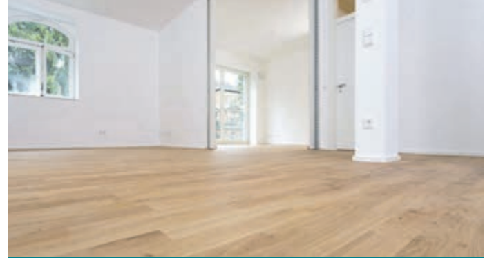
Bodenaufbau und Estrich ermöglichen im Zusammenspiel eine energiesparende Wärmeversorgung. Foto: djd
