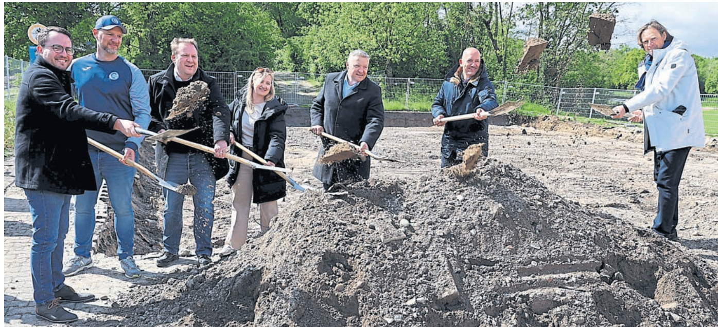
Es kann losgehen: Mit einem symbolischen ersten Spatenstich eröffneten (von links) Elias Gärtner (TSV-Vorsitzender), Timo Grommes (Vorsitzender SV Concordia), Jörg Muntermann (Architekt), Ann-Kristin Koch (Team Stadtumbau), Peter Burger (Bürgermeister), Knut Krieger (Stadtarchitekt) und Harald Noll (Landschaftsarchitekt) die Baustelle für das neue Sportheim. haza-foto
