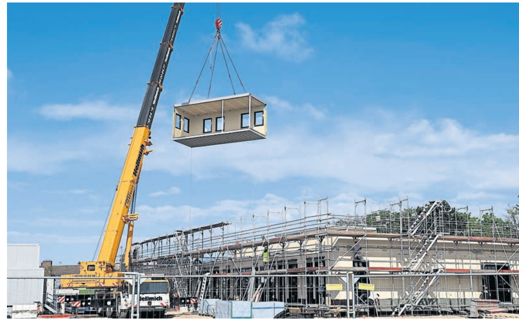
Schwebende Büroräume sorgten bei den zukünftigen Kindergartenkindern der Bewegungs-Kita in Stockstadt für große Augen bei den Kleinen. Auch die großen Gäste staunten nicht schlecht, wie zügig so ein Aufbau dadurch vorangehen kann. haza-fotos (2)
