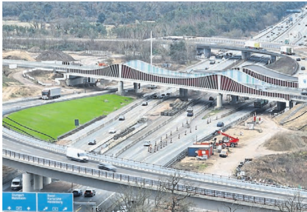
Das Zentralbauwerk am Darmstädter Kreuz wird in den kommenden Wochen verschoben. Das hat auch Auswirkungen auf den Verkehr. Foto: Autobahn GmbH/Kaluscha
