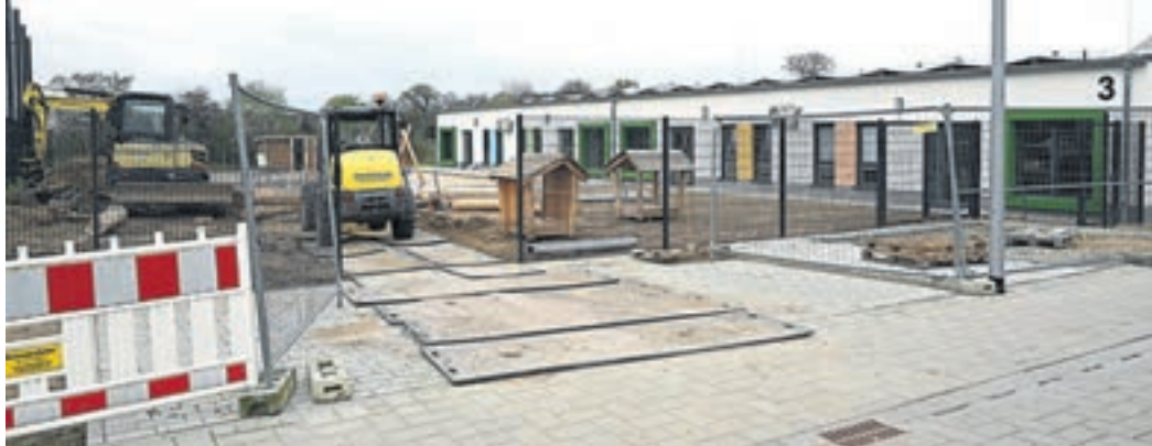
Der noch nicht fertiggestellte Außenbereich der Kita Naturbande sorgt neben der Personalsituation in der Kita für Kritik in der Elternschaft. Foto: Burmeister
