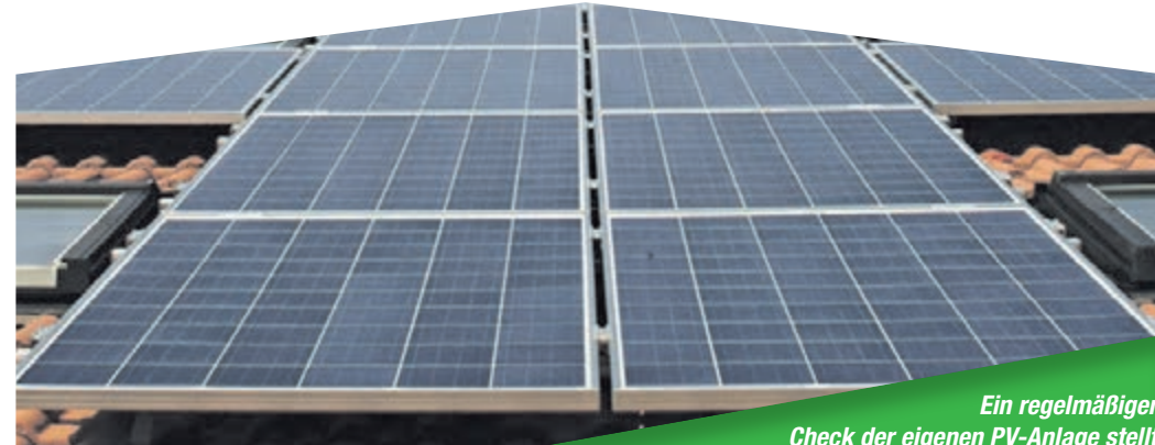
Ein regelmäßiger Check der eigenen PV-Anlage stellt sicher, dass diese so effizient wie möglich Energie erzeugen kann. Foto: Pixabay
