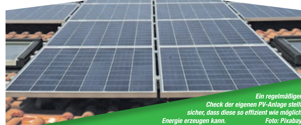
Ein regelmäßiger Check der eigenen PV-Anlage stellt sicher, dass diese so effizient wie möglich Energie erzeugen kann. Foto: Pixabay
