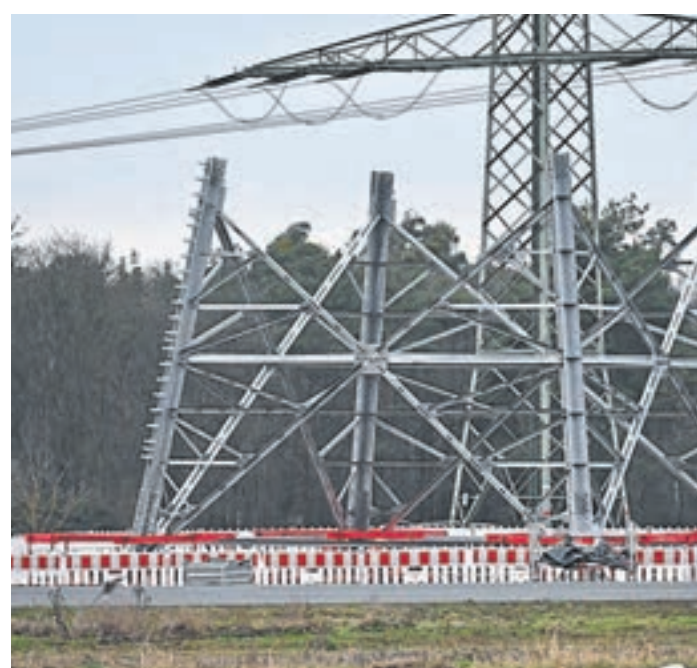
Größtenteils parallel zur bestehenden Hochspannungsleitung baut Netzbetreiber „Amprion“ gerade neue Masten für eine verstärkte Trasse mit mehr Kilovolt. Foto: Weißmann
