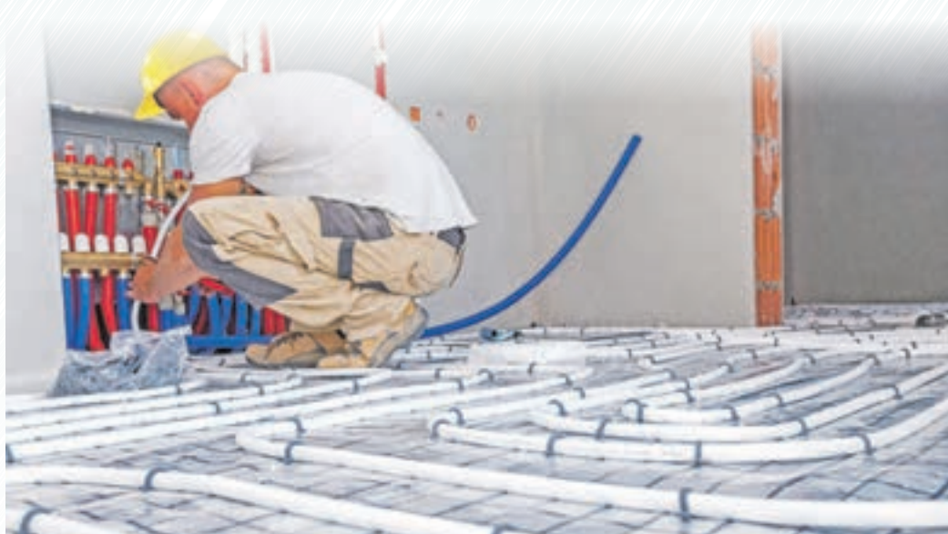
Fußbodenheizungen werden in der Regel in Fließestrich verlegt. Dieser muss fachgerecht getrocknet werden, bevor er belegt werden kann. Foto: djd
